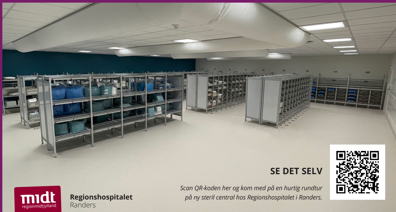
Overview efter installation.
